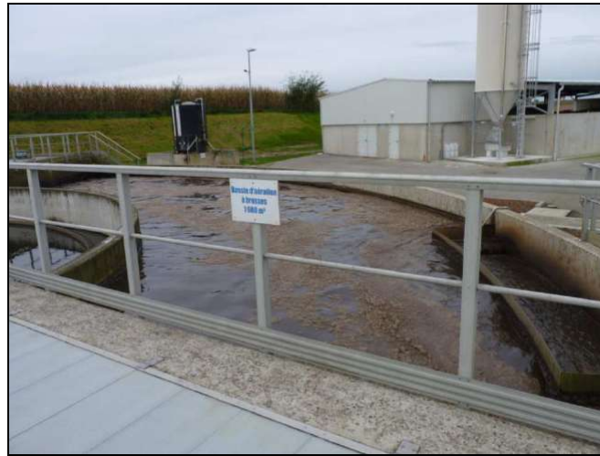
Photo 2: Station d'épuration de Rosières-en-Santerre (novembre 2013)
