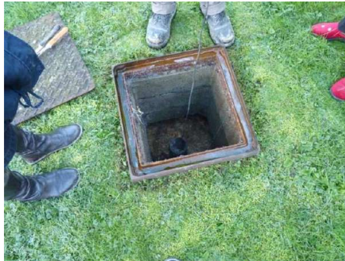
Contrôle de bon fonctionnement à WARVILLERS (novembre 2013)
